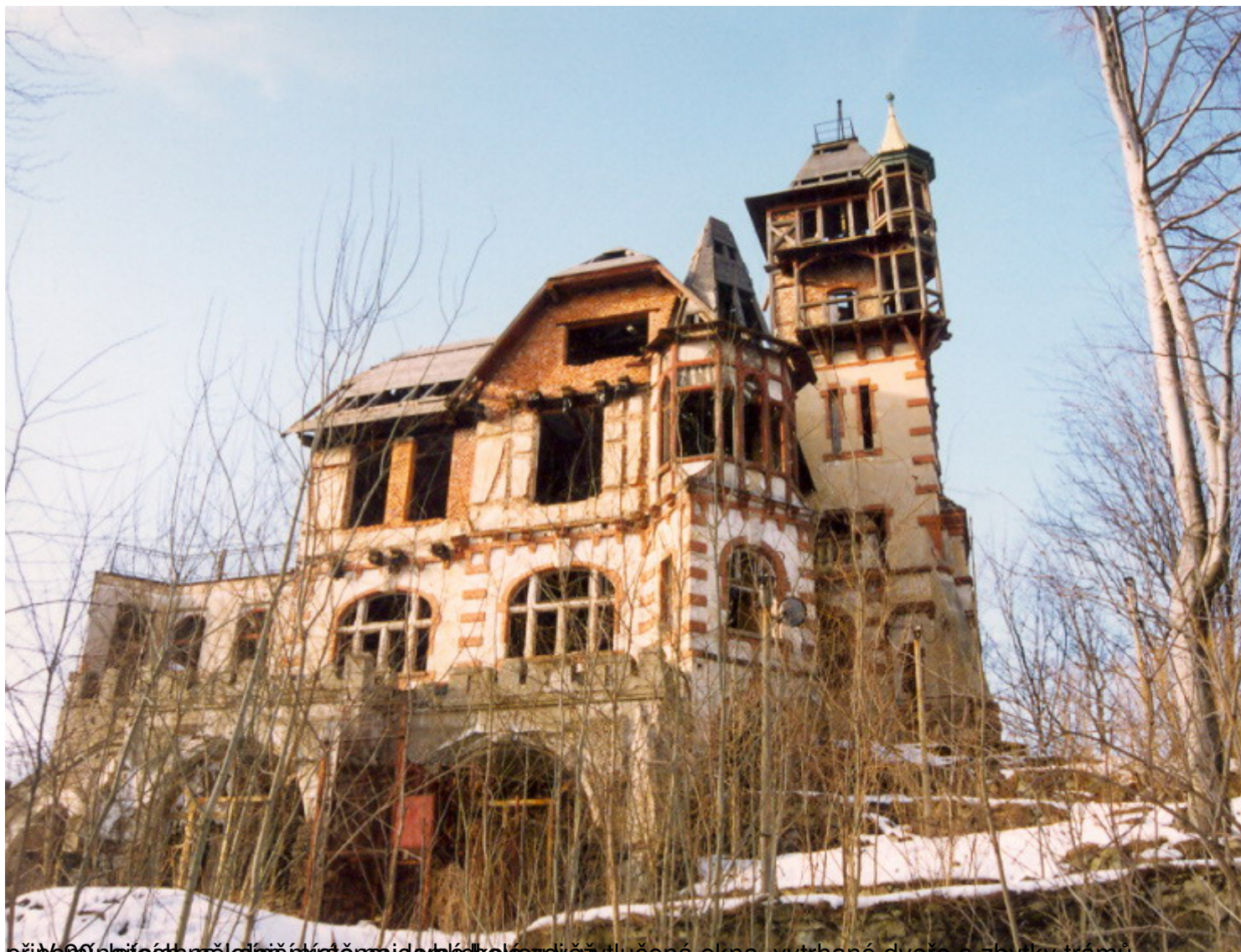
připovědění, nejvíce zničená část je vpravo, kde se nachází vytlučená okna, vytrhané dveře a zbytky trámů
